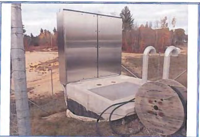
Bassin épurateur (équipement)
